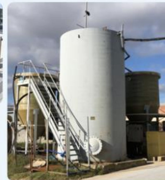
工場排水の浄化システム
