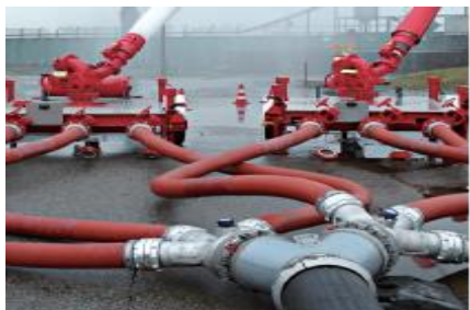
緊急消火システムホース
